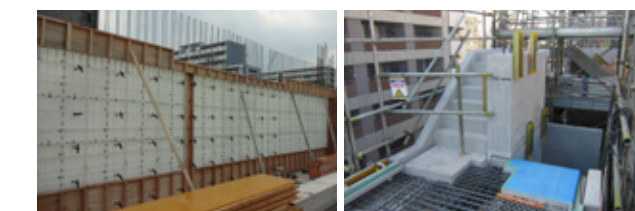
樹脂型枠の使用状況(一部木製型枠) PCa部材使用状況(フルPCa階段)
