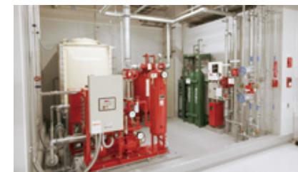
消火設備研修ゾーン
